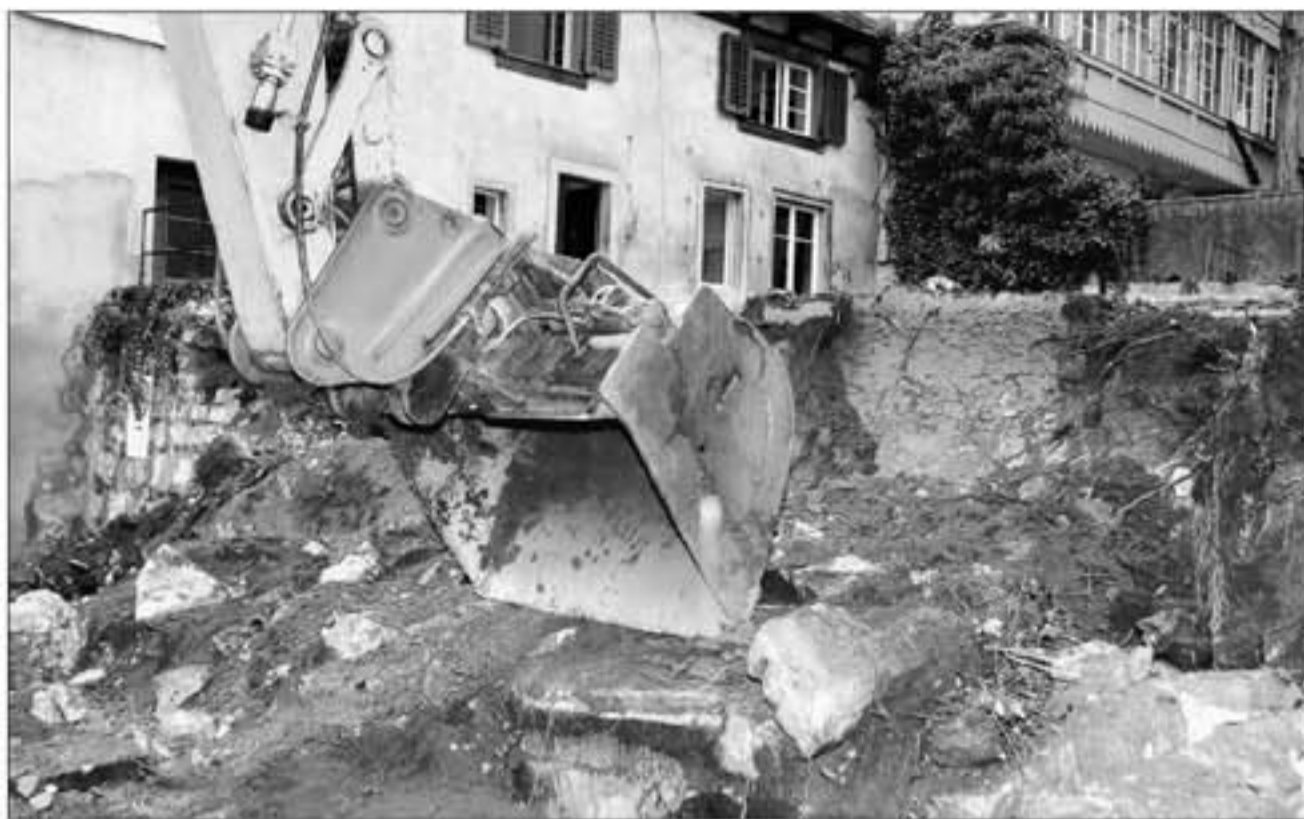
Der Bau hat begonnen: Baureferent Kurt Schönberger führte gestern mit dem Bagger den ersten «Hammerschlag» für die Überbauung Herrenacker Süd aus.
